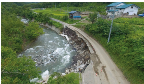
岩泉町小屋敷地区の県道 177 号被災状況
